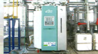
④蒸気ボイラ
