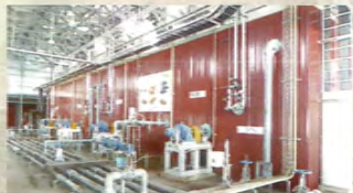
⑤箱型発酵槽(4基)
