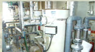
⑦温水ボイラ
