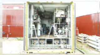
③バイオガス精製圧縮充填装置
