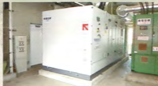
⑥ガス発電機
