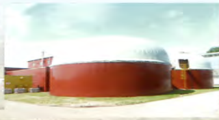
②円柱形発酵槽(2基)
